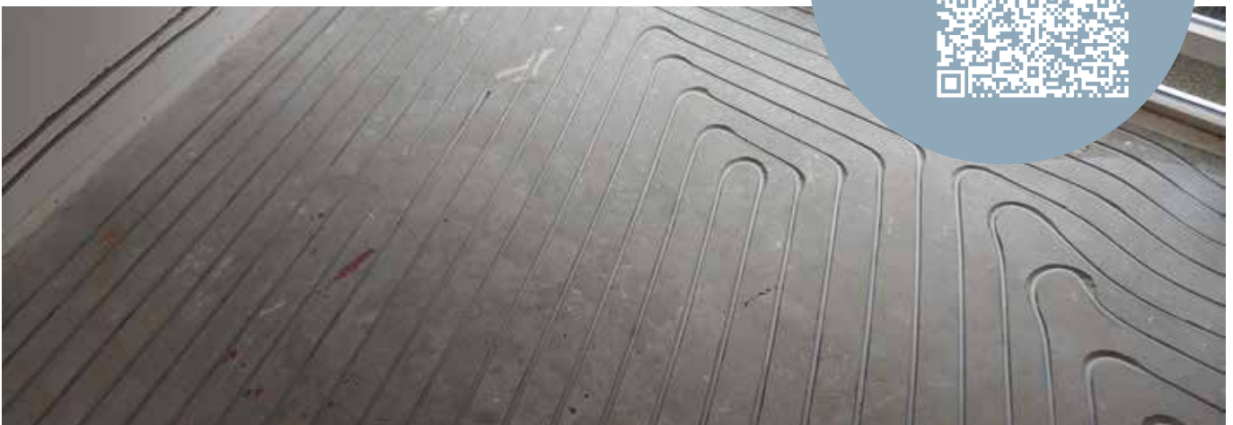
TBA is niet al te positief over het infrezen van vloerverwarming in oude vloeren. De kans dat het later schade oplevert is levensgroot.
