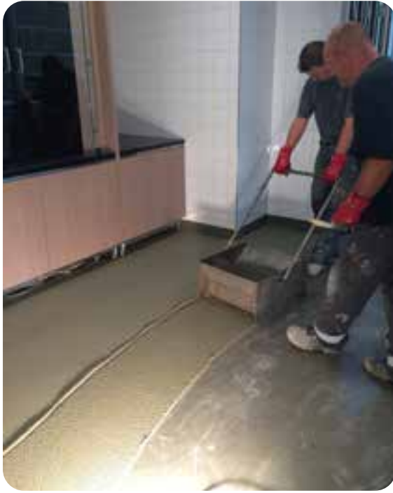
Voorbeeld van een screedbox. Let op, ondanks de afstand tot de vloer is het dragen van korte mouwen niet aan te raden vanwege de kans op huidcontact.
