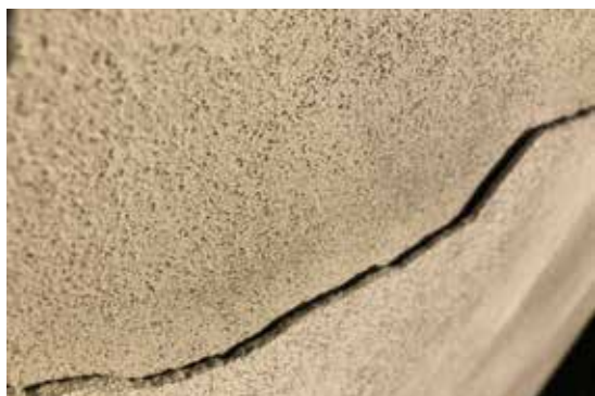
De buitenste stuc laag heeft een dikte van 4 tot 5 mm en hecht onvoldoende aan de hieronder gelegen stuc laag.
