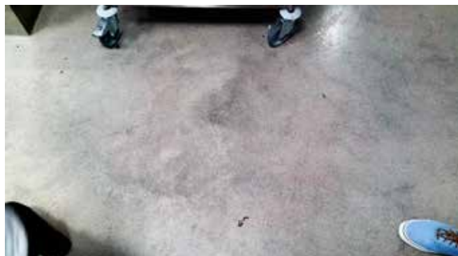
Ernstige verkleuringen in het vloerooppervlak
