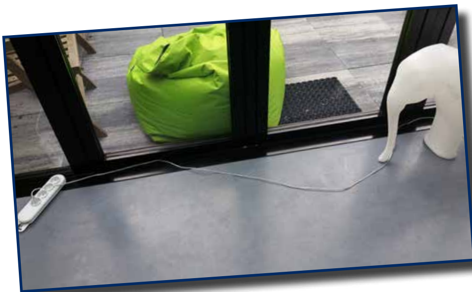
Aansluiting met pui. Hogere betonvloer langs deze pui kon niet worden gerealiseerd.
