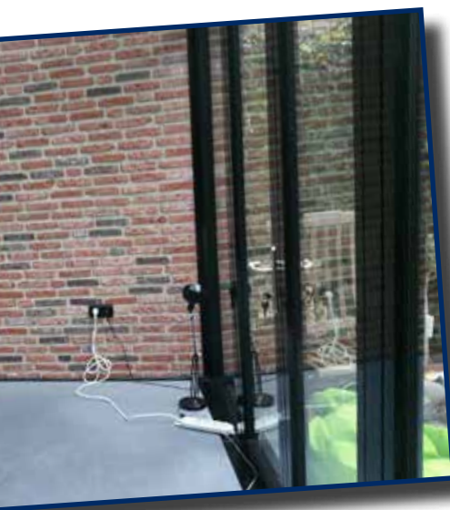
Vloer met afschot naar pui, maar metselwerk daalt nóg sterker.
