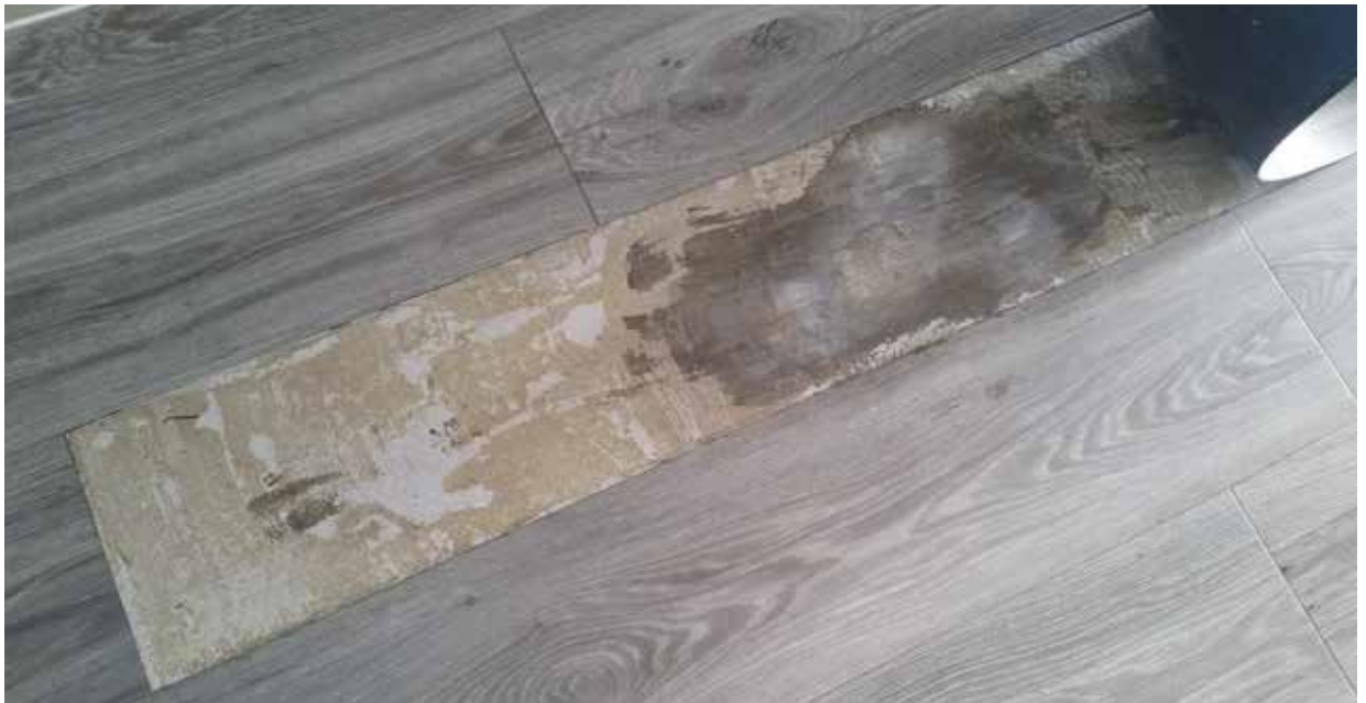
Bij oplichten van vloerbedekking in de woonkamer is geen scheurvorming in de egaline zichtbaar, wel een reparatie en onvlakheid.
