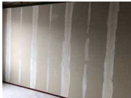
Schaduwlijn diagonaal over de wand. Bruiner oppervlak.
